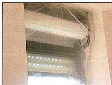
Figure 2 : Protection d'une menuiserie
